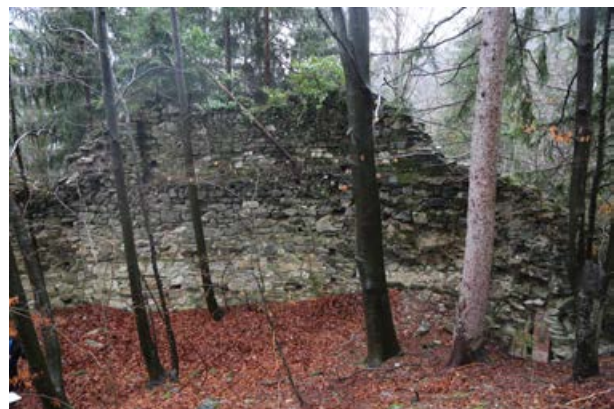
Pogled na zahodni del grajskega obodnega obzidja z lokacije nekdanjega palacija. Na levi strani je v zgornjem delu viden ostanek nestanjšanega dela obzidja, na desni strani spodaj pa poškodovana severozahodna trapezasta odprtina.
